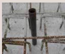
Fig. 2 Fourreau en acier noyé dans le béton
