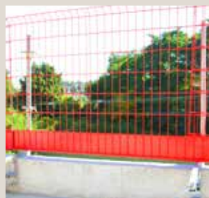
Fig. 3 Pince fixée sur structure verticale
